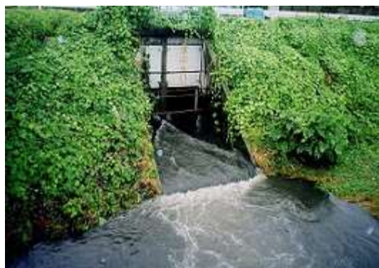
雨天時の合流式下水道からの放流水
