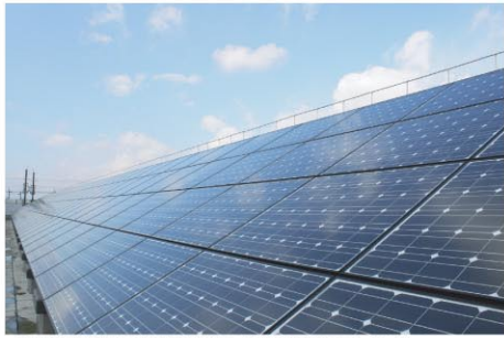
▲南図書館に設置された太陽光発電システム
