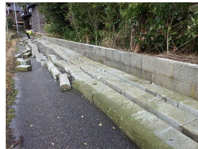
倒壊した外壁
