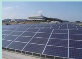
松田新田浄水場
