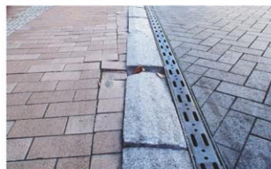
▲路面の凹凸が目立つ道路
