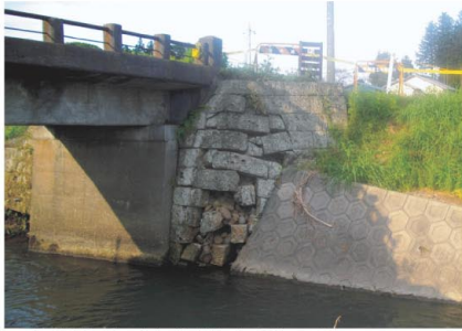
▲集中豪雨により被災した橋りょう
