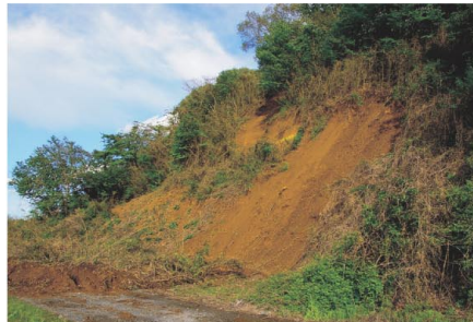
▲震災などで被害を受けた飛山城史跡公園の崖地
