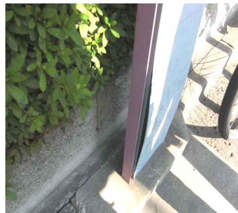
写真4 台座との隙間
