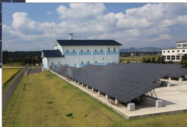
白沢浄水場の太陽光発電設備
