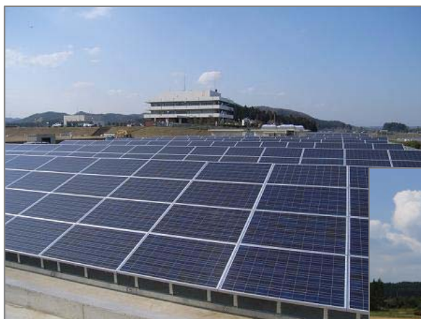
松田新田浄水場の太陽光発電設備
