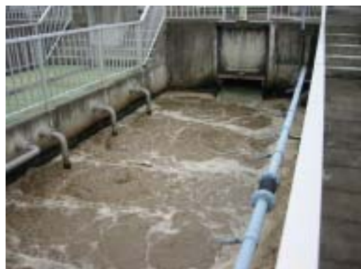
反応タンク（エアレーションタンク）
