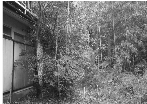
写真2 整備困難な空き家裏
