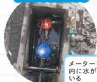
メーターボックス内の漏水
