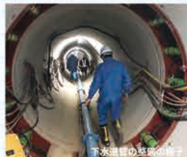
下水道管の空洞の様子
