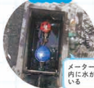
宅地内の漏水
