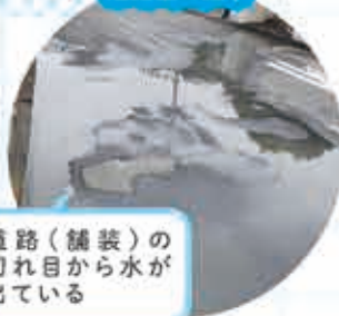
道路上の漏水
