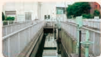
⑤ 消毒設備
