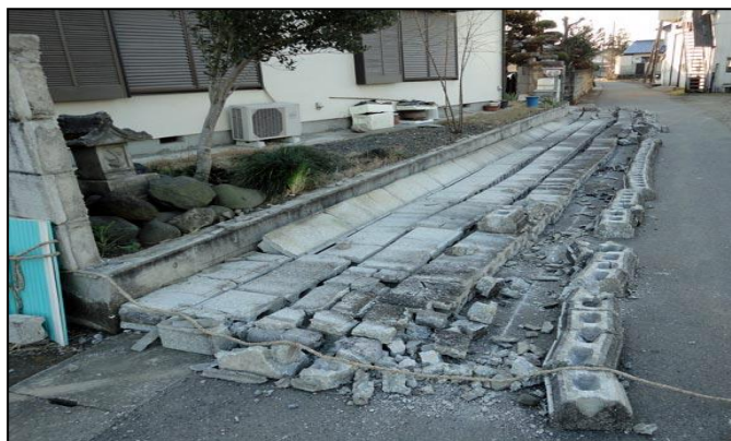
ブロック塀の倒壊
