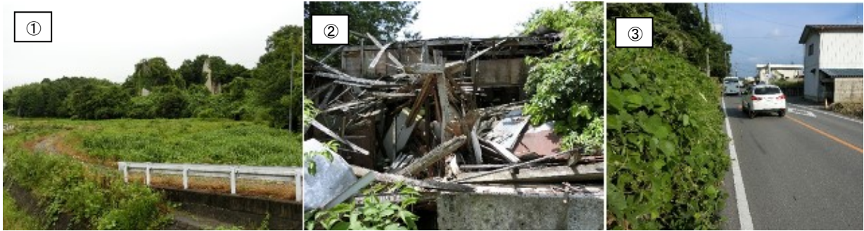
写真2 景観を損ねる廃屋・草木の繁茂(①7月7日、②5月25日、③8月14日撮影)
