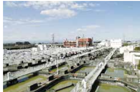
川田水再生センター
