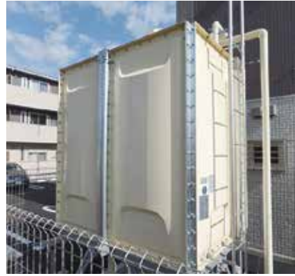
小規模貯水槽水道
