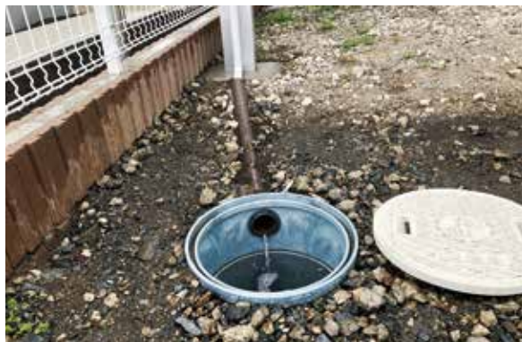
雨水浸透施設
