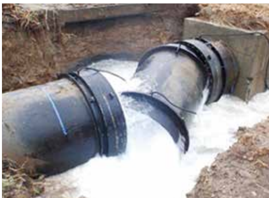
水道管の継手の破損（他市）
