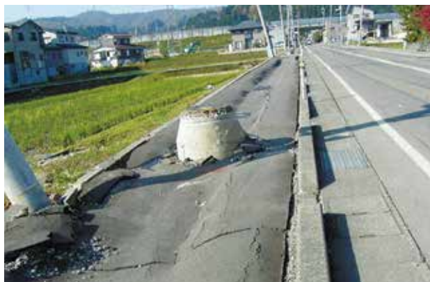
マンホールの浮上（他市）
