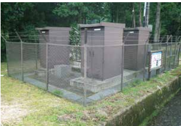
小水力発電 (第3減圧所)
