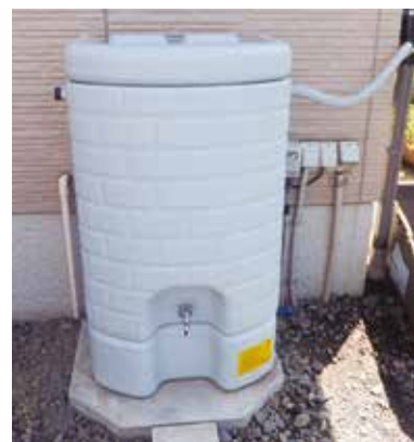
雨水貯留施設
