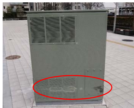
地上用変圧器の損傷 (東京電力パワーグリッド(株)所有)
