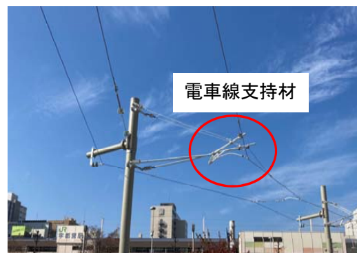
電車線支持材の損傷
