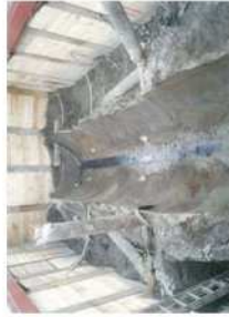
写真2 倒壊した支柱
