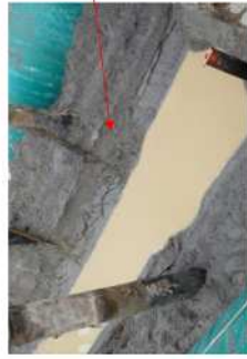
写真1 指針と異なる施工事例
